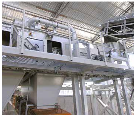
Instalacja BMP w Kosinach Bartosowych
