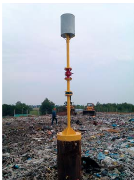
Składowisko odpadów komunalnych – pochodnia
