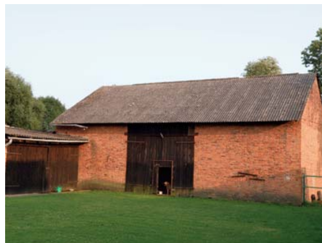
Budynek gospodarczy pokryty azbestem
