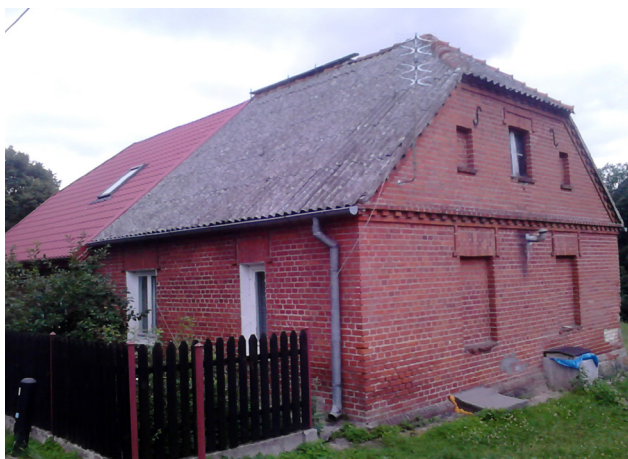
Budynek mieszkalny pokryty azbestem
