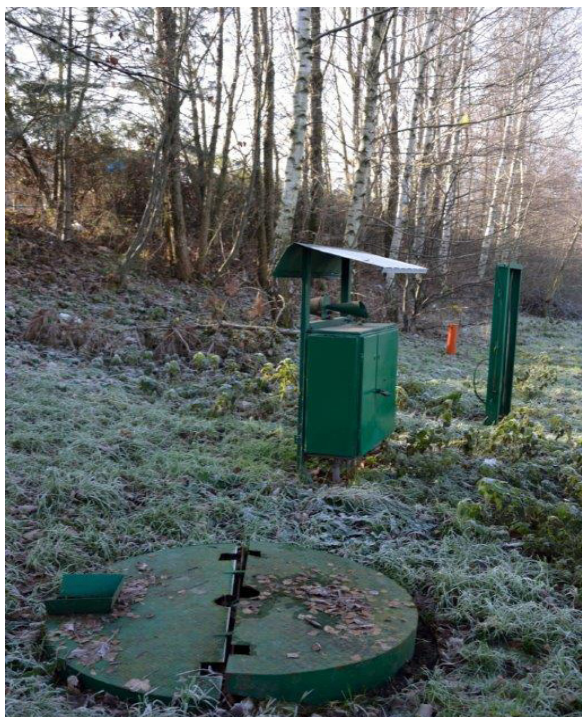
Opomiarowanie monitoringowe składowiska odpadów komunalnych
