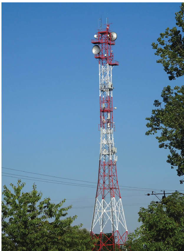
Stacja bazowa telefonii komórkowej w Brzegu
