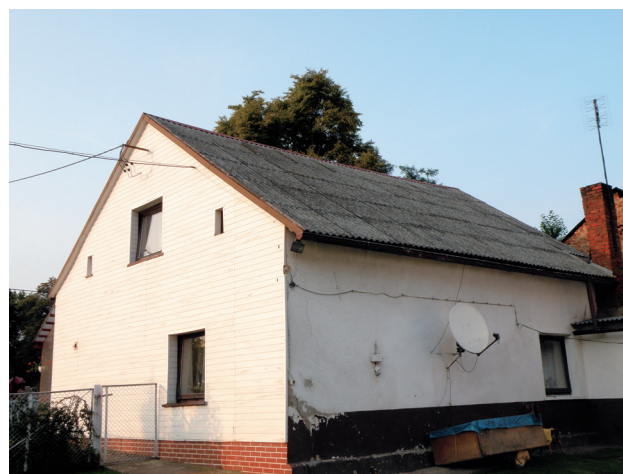
Budynek mieszkalny pokryty azbestem
