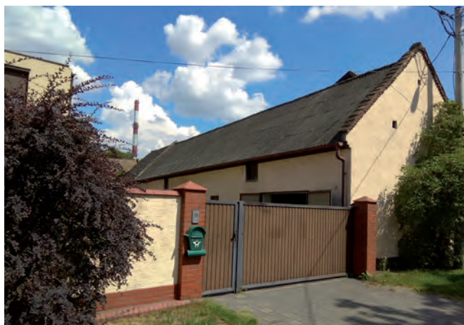
Budynek gospodarczy pokryty azbestem
