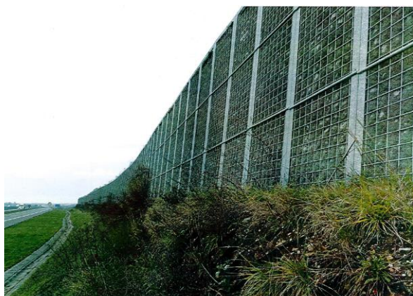
Ekran akustyczny w ciągu autostrady A4 w rejonie miejscowości Malnia (źródło: GDDKiA oddział w Opolu)
