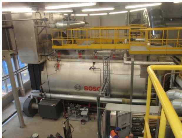
Kocioł olejowy LOOS (źródło: PGE GiEK S.A. Oddział Elektrownia Opole)
