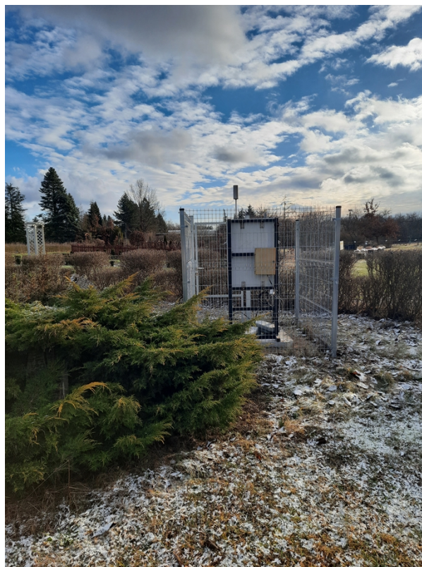
Stacja przy ul. Jeździeckiej
